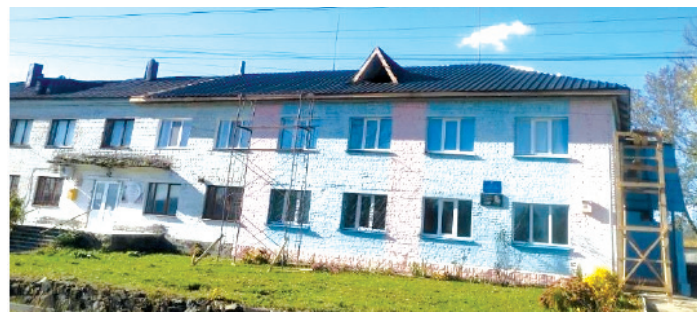
ПОТОЧНИЙ РЕМОНТ ПОКРІВЛІ БУДІВЛІ КЗ «ШУБКІВСЬКА ШКОЛА МИСТЕЦТВ ІМЕНІ АНАТОЛІЯ ПУЗИРКА» та придбання музичних інструментів на суму – 1 020 194 грн
